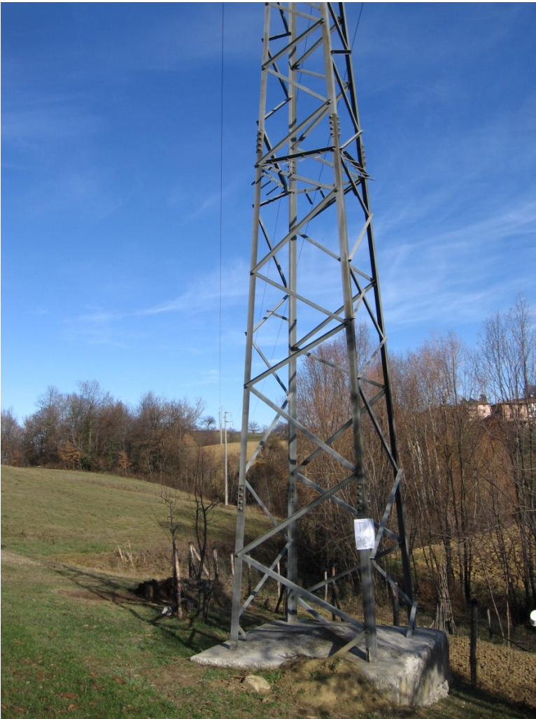
Vista attuale del traliccio nr.24– Tronco 1, da sostituire con palo in acciaio.
