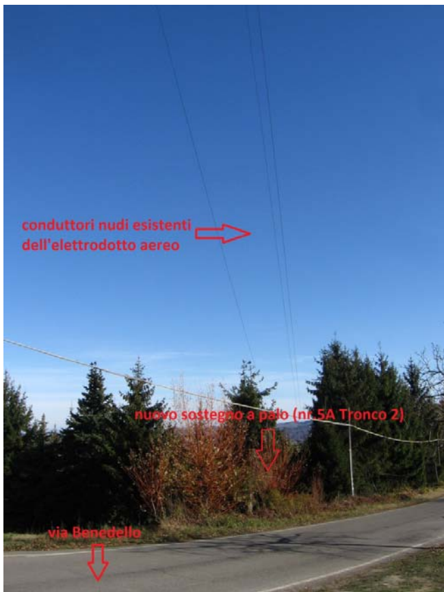
Vista attuale del posizionamento del nuovo palo in acciaio da infiggere: nr.5A – Tronco 2.
