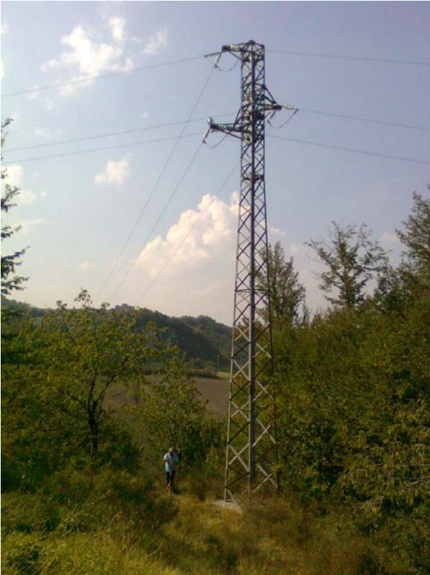
Vista attuale del traliccio nr.10 Tronco 2, da sostituire con nuovo palo in acciaio.
