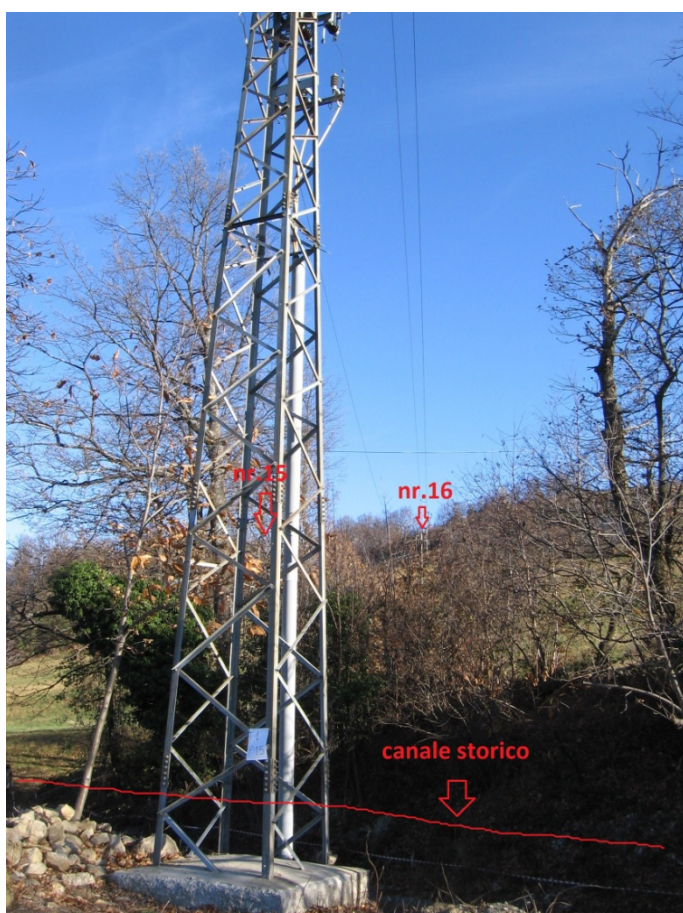
Vista attuale del traliccio nr.15 (con palo nr.16 in sfondo) – Tronco 1, da sostituire con palo in acciaio.
