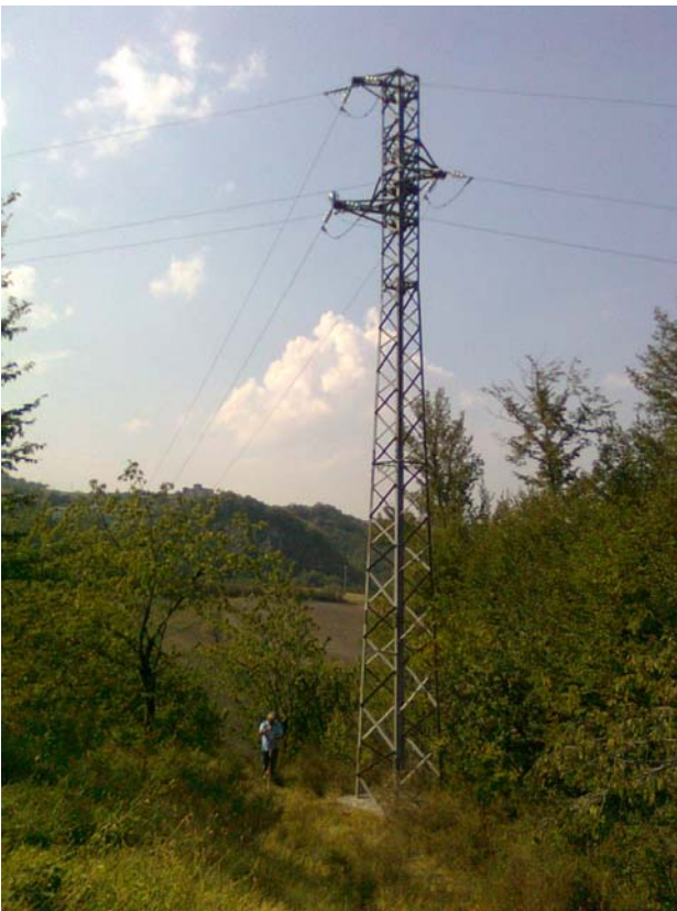
Vista del passaggio dell'elettrodotto esistente su uno dei tralicci.
