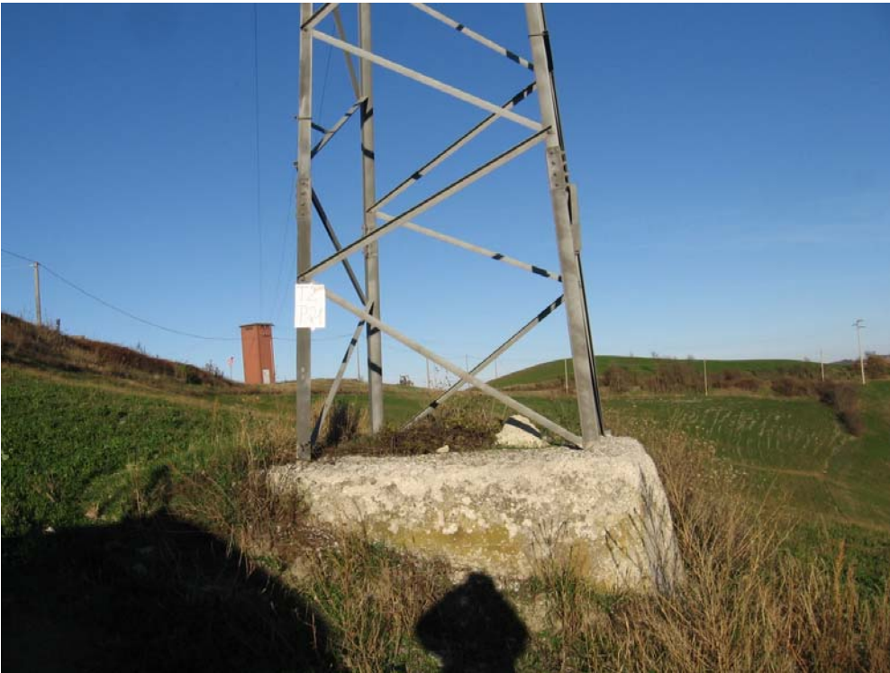
Vista attuale del traliccio nr.21– Tronco 2, da sostituire con palo in acciaio.
