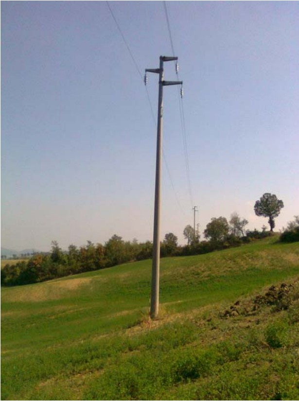
Vista di tratto di palificazione aerea esistente dell'elettrodotto in proposta di adeguamento
