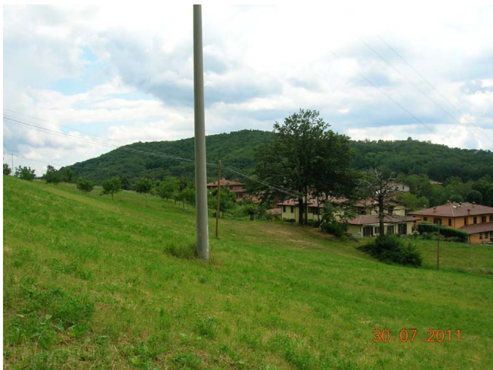
Vista attuale del traliccio nr.16 – Tronco 1, da sostituire con palo in acciaio.
