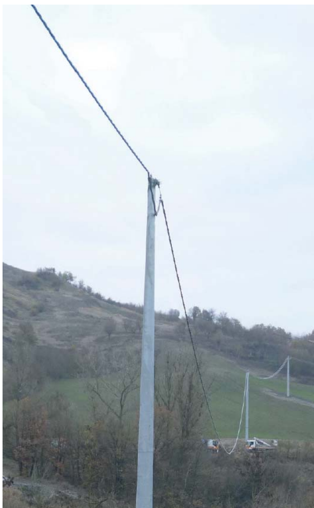
Vista panoramica di esempio di palificazione con conduttore elicord su territorio montagnoso-collinare della provincia emiliana.
