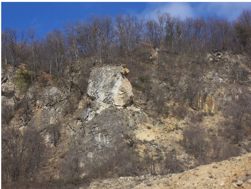
Fotografia 5: un prisma roccioso in condizioni di potenziale instabilità sul versante nord-orientale dell'area di cava. Si intuisce la discontinuità basale che potrebbe divenire superficie di scivolamento.
